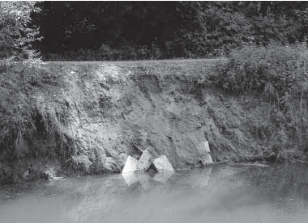
Die mit Steinplatten provisorisch befestigte Böschung der Leine in Höhe des Maschsees. Die Bruthöhle des Eisvogels liegt etwa 1 m neben der Schüttung und wurde nur durch Zufall nicht vernichtet. Foto: Dieter Wendt
